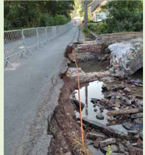
Dégâts d'intempéries fonds de Lustin
